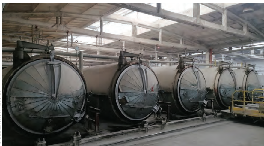
ZAMONTOWANE URZĄDZENIA W 1968 R. W ZBK W BUDACH GŁOGOWSKICH DZIAŁAJĄ DO DNIA DZISIEJSZEGO
