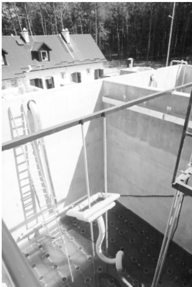
Wnętrze reaktora biologicznego oczyszczalni ścieków przed zapelnieniem.
