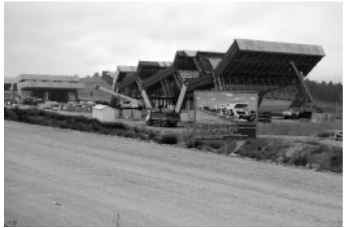
Powstająca elektrownia słoneczna w środkowej Gruzji to jeden z przykładów inwestycji Unii Europejskiej w tym kraju
