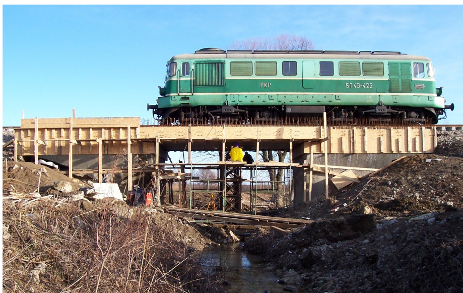
Lokomotywa ST43-422 podczas próby obciążeniowej na moście w kilometrze 39,354 linii Ocice – Rzeszów
