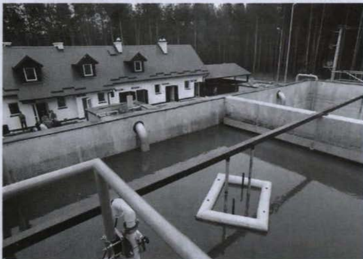
Widok reaktora biologicznego, w którym oczyszczają się ścieki.
