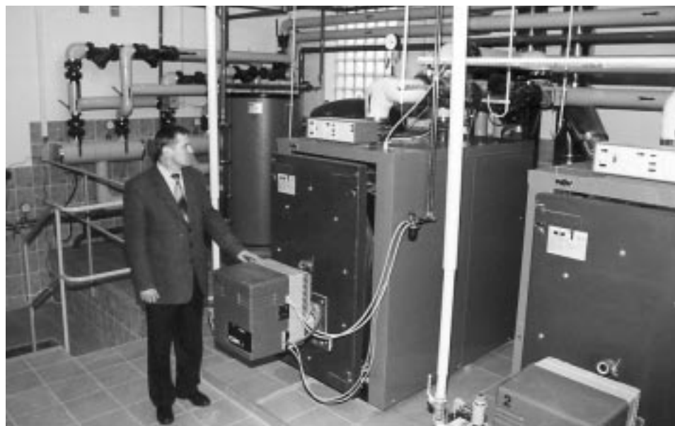
Dyrektor Kubiś prezentuje nowoczesną kotłownię wykonaną za pieniądze powiatu.
