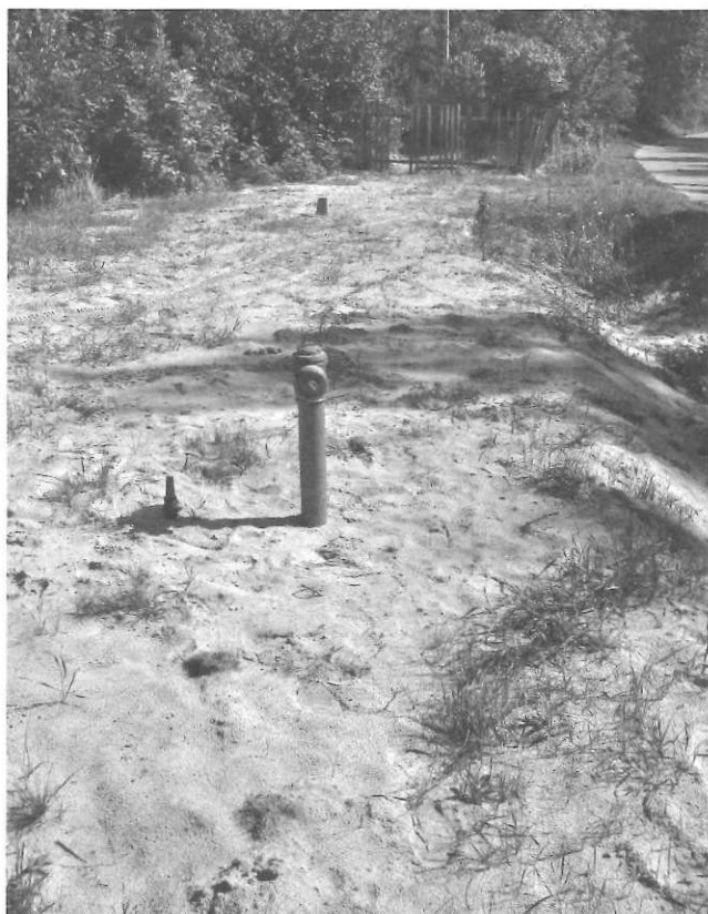
Sieć wodociągowa w Kłapówce
