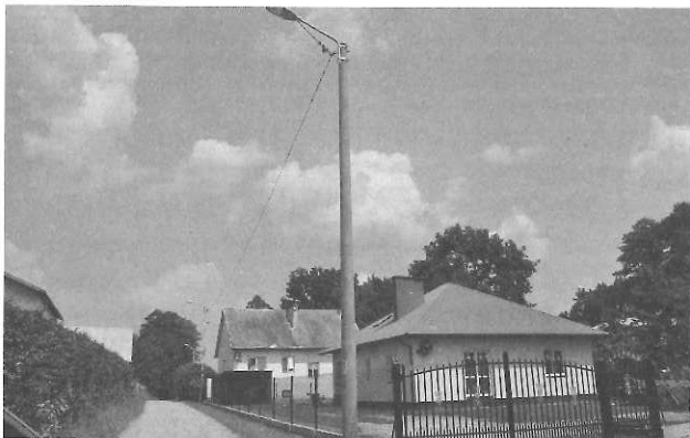
Nowe oświetlenie uliczne
