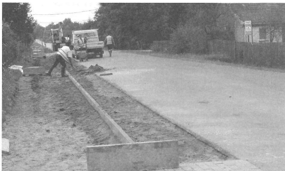
Prace przy budowie chodnika w Dzikowcu, przy drodze powiatowej Jagodnik – Cmolos – Mechowiec – Dzikowiec, już się rozpoczęły. Fot. B. Żarkowska
