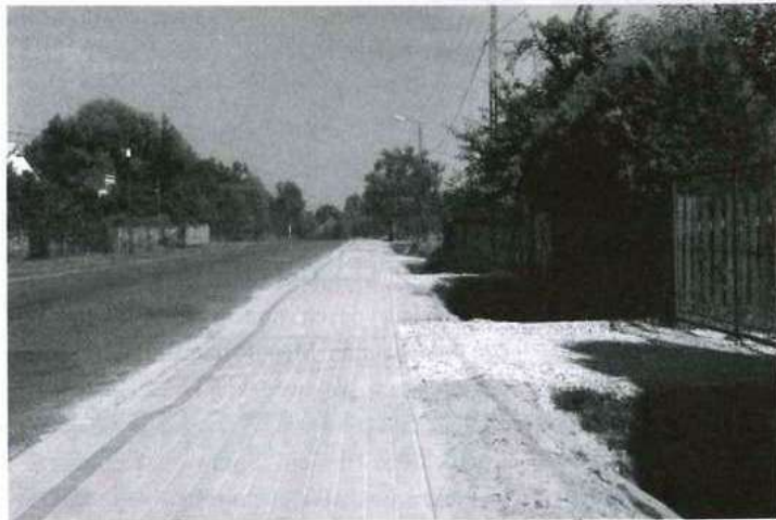
Budowa chodnika dla pieszych przy drodze powiatowej Nr 1 204 R Majdan Królewski- Kopcie-Lipnica-Raniżów-Głogów Małopolski, km 17+414-17+764, 350 mb. Wartość inwestycji: 94 807,00 zł. Fot. A. Jarosz
