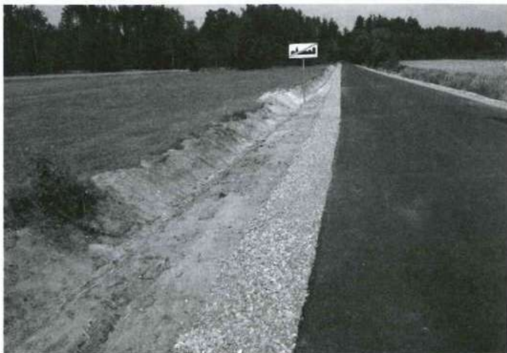
W ramach likwidacji szkód powodziowych trwa odbudowa drogi powiatowej Nr 1 209 R Zielonka-Korczowska w km 3+562-4+173; 611 mb. Fot. A. Jarosz
