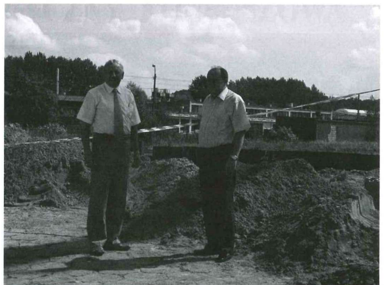
Posel na Sejm RP Zbigniew Chmielowiec i Starosta Kolbuszowski Józef Kardys wspólnie sprawdzają na jakim etapie są prowadzone prace na kolbuszowskim odcinku torów. Fot. A. Jarosz
