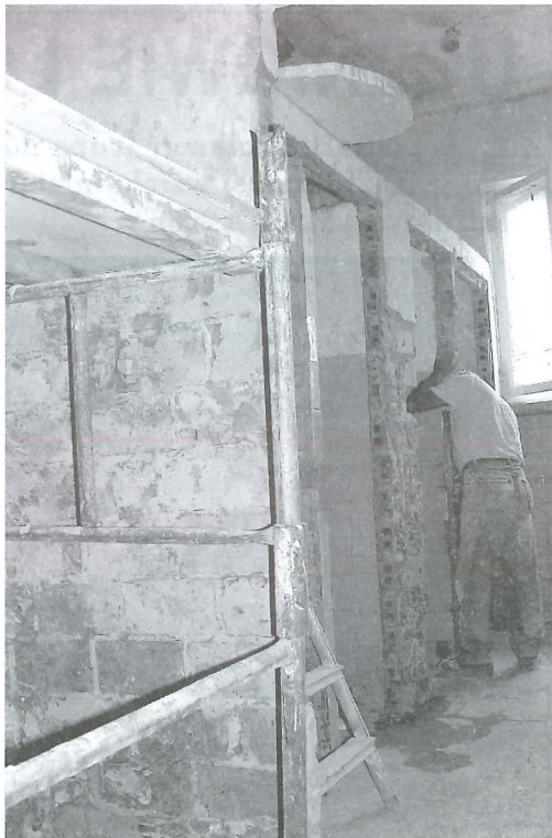
Trwają intensywne prace remontowe. Na zdjęciu skuwanie starych tynków i płytek. Fot. B. Popek
