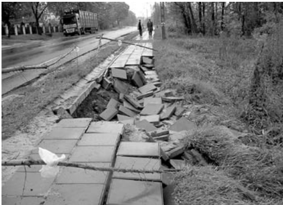
Chodnik w Widełce po przejściu "wielkiej wody".
