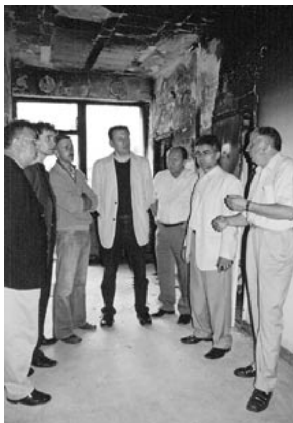
Wicewojewoda (w środku) w obecności dyrektora i przedstawicieli samorządów wszystkich szczebli, ogląda rozmiary zniszczeń. Fot. B. Popek
