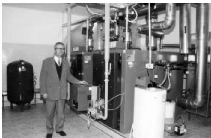
Nowoczesna kotłownia gazowa c.o. w Zespole Szkół Zawodowych. Druga taka sama powstała w Zespole Szkół Rolniczych.
