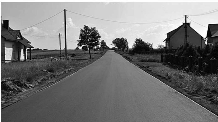
Zakończono remont odcinka nr 1 208 R Poręby Wolskie – Posuchy na długości odcinka 1168 mb. Fot. A. Jarosz
