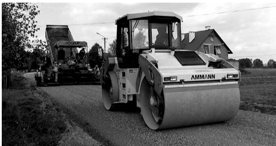
Rozpoczęły się prace polegające na przebudowie drogi powiatowej Nr 1 227 R Trześć – Domatków – Bukowiec – Kupno w miejscowościach Bukowiec i Domatków. Fot. A. Jarosz
