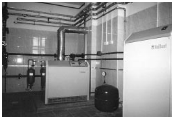
Wnętrze nowoczesnej kotłowni gazowej w szkole w Mazurach.
