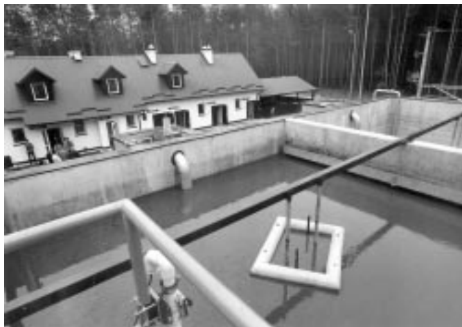
Widok na gminną oczyszczalnię ścieków w Raniżowie.
