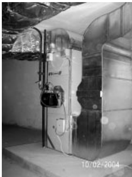
Znajdujący się w piwnicach kościoła piec c.o. i urządzenia nadmuchowe.
