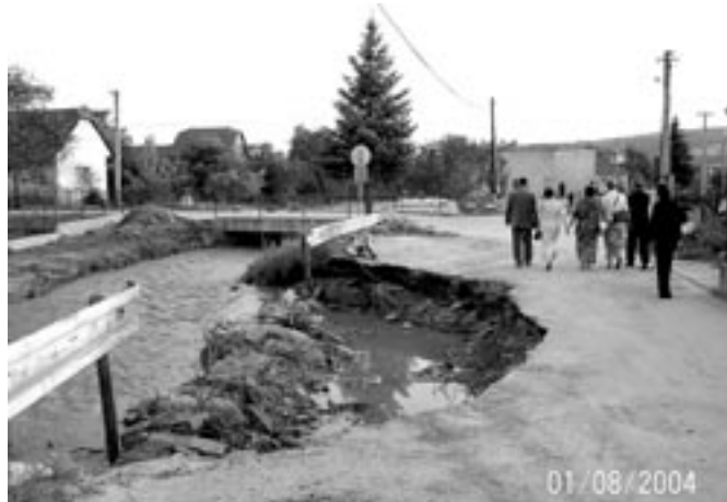
W piątek 30.07. rwąca woda ze strumyka potrafiła wyrządzić między innymi takie szkody.
