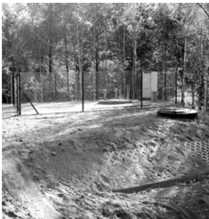
Przepompownia P1 na Pozduci obok mostu.
