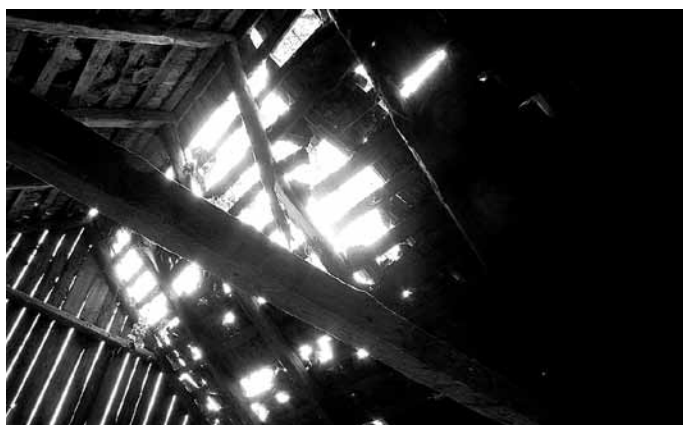
Zniszczony dach stodoły.
