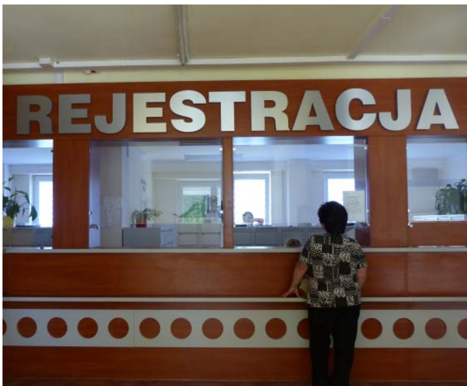
Nowo przebudowana rejestracja w Przychodni Rejonowej nr 1 w Kolbuszowej. Fot. B. Żarkowska
